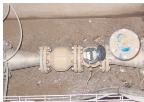
Compteur général sur la distribution
