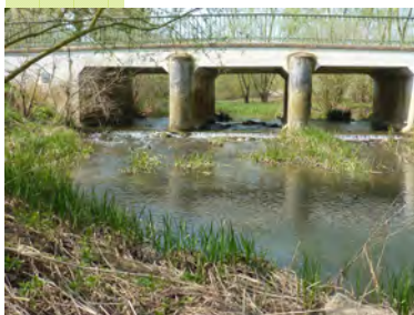
Formation d'un atterrissement à l'aval d'un pont
