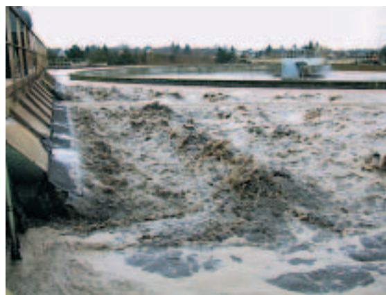
Photo 2 – STEP de Châteauroux (36) : chenal d'aération (A. Héduit, oct. 2002).
