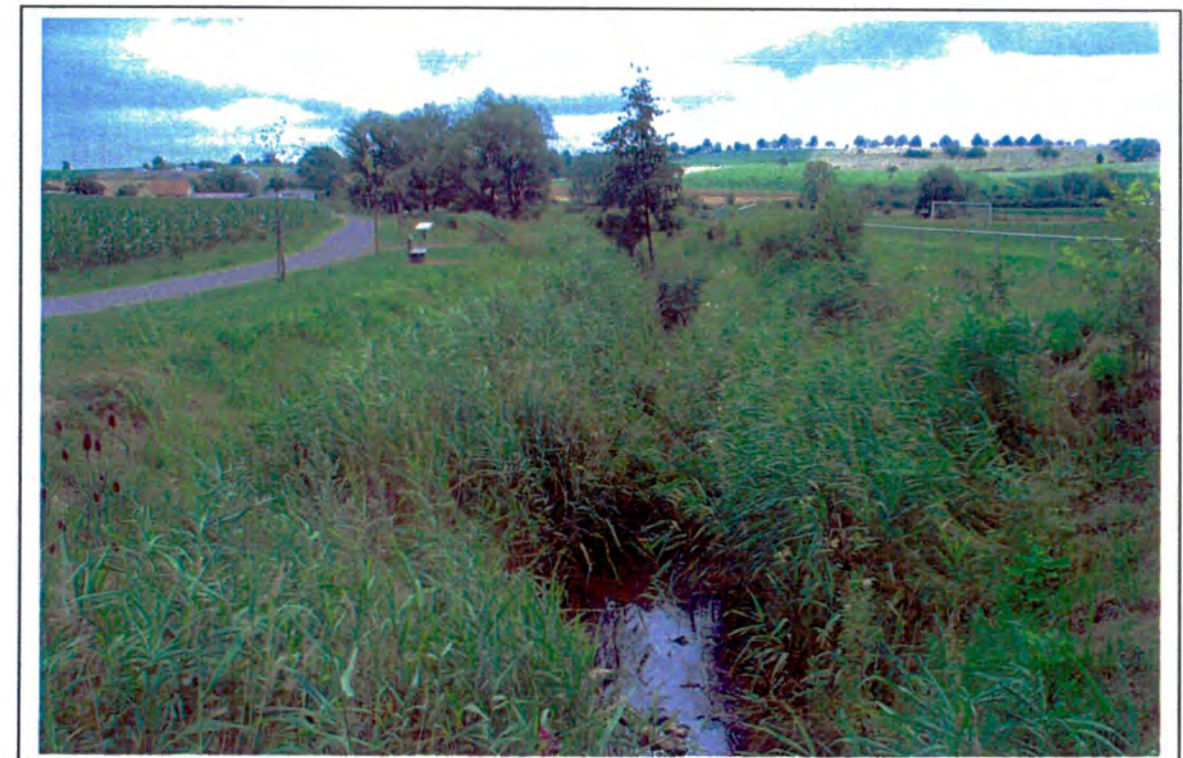
Aval de la passerelle : lit mineur d'étiage moins réussi que le précédent. Quelques-uns des blocs qui en constituaient l'assise ont été entraînés dans le chenal, et la végétation a tendance à envahir le gabarit d'écoulement.
