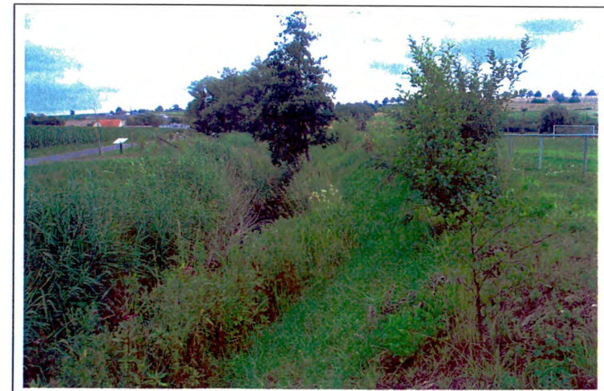
Décaissement de la berge droite avec mise en place d'une fascine d'hélophyte en pied de berge, ensemencement du talus et plantations en haut de berge.
