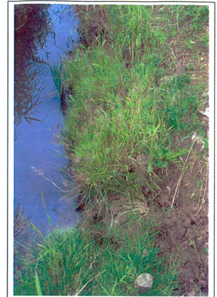
Amont de la station d'épuration : la fascine a été détruite par piétinement. Elle devra être reconstituée afin de ne pas déstabiliser le reste de l'ouvrage.
