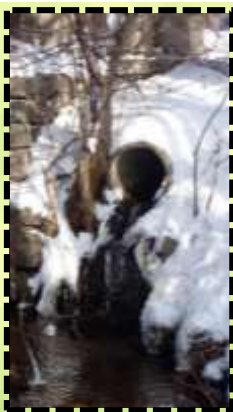
Buse au niveau du ruisseau des Xettes
