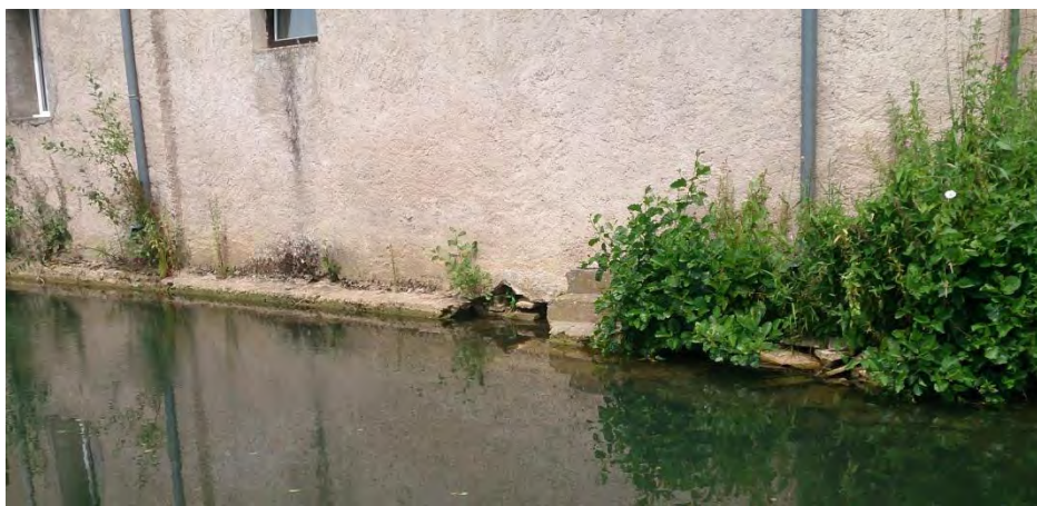
Fig. 41. Etat de mur d'habitation à l'amont de l'ouvrage ROE122
