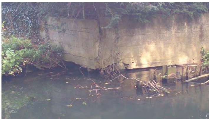
Fig. 52. Etat de muret de jardin privé à l'amont de l'ouvrage ROE52395
