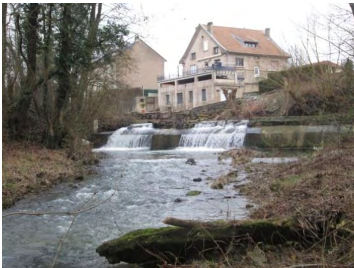
Fig. 6. Ouvrage ROE117, localisé au droit de la station d'épuration d'Hettange-Grande
