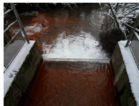
Déversement du réservoir Centre dans le Chevillon (galerie du Woigot)
