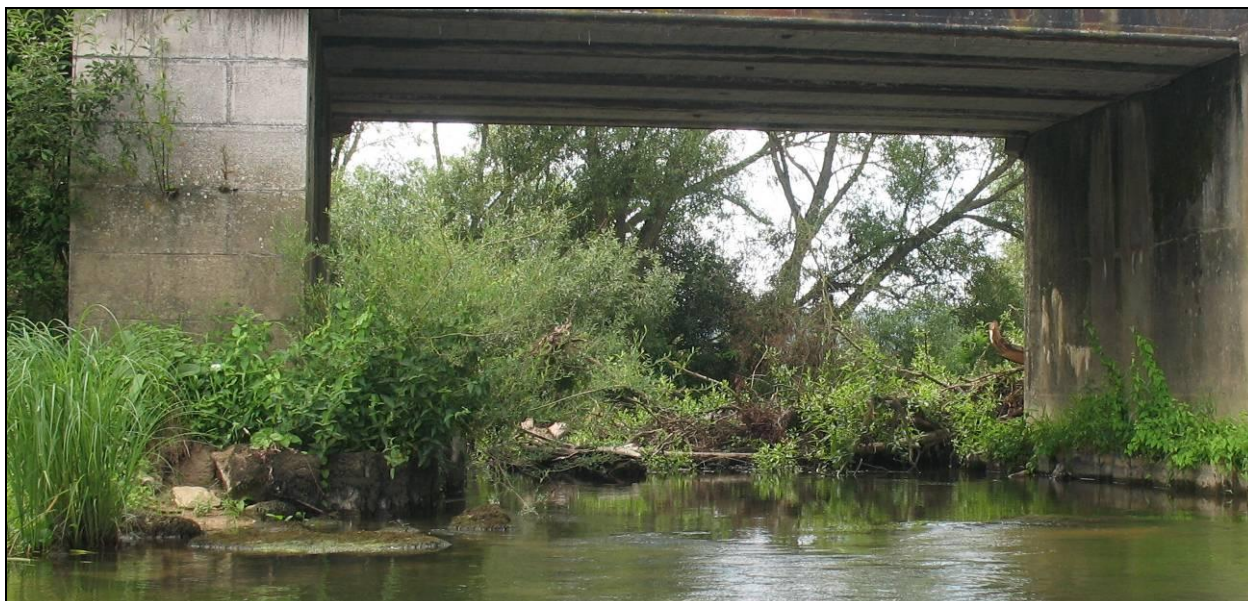
Figure 25 : Embâcles au niveau d'un pont à Brixey-aux-Chanoines
