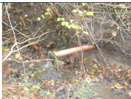
émissaire de drainage sortant vers le ruisseau
