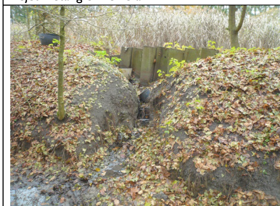
digue chaotique d'un étang
