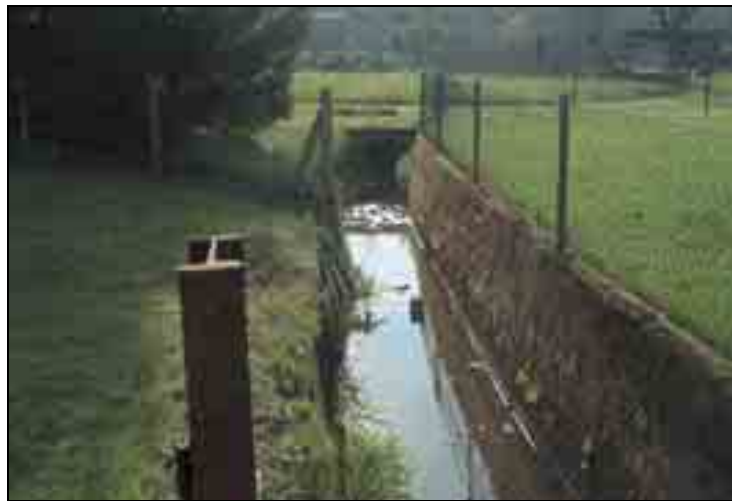
canalisation souterraine du Mutterbach à Farschviller Photo ECODEVE
