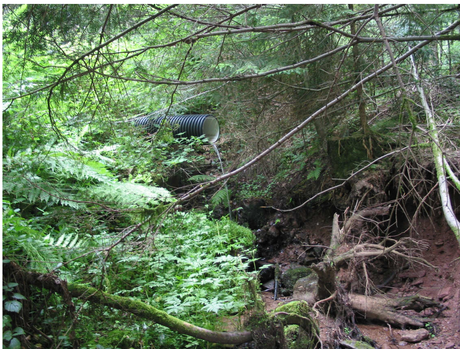
Photo n° 5 : Passage en buse avec forte hauteur de chute à l'aval au passage sous route forestière à l'altitude 570m
