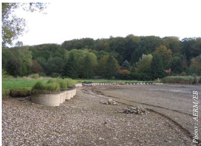
Berges de l'étang du Marais avant travaux : protection contre le battillage par un tunage en béton
