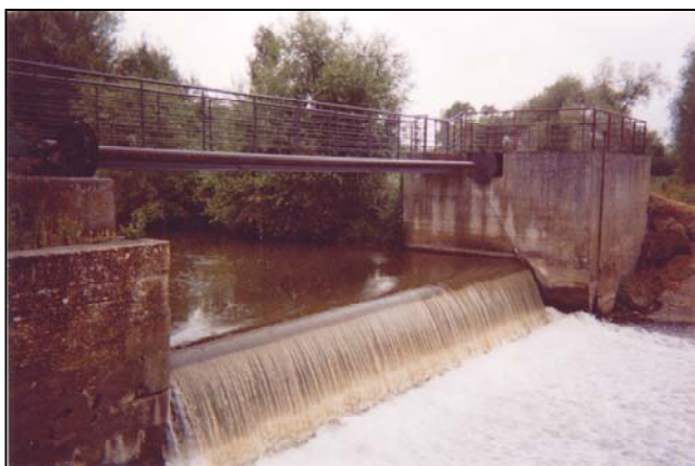
Le barrage infranchissable sur la Seille à Magny (Se 30f) : impact en amont sensible sur un linéaire important, du fait de la faible pente. Photo ECOLOR
