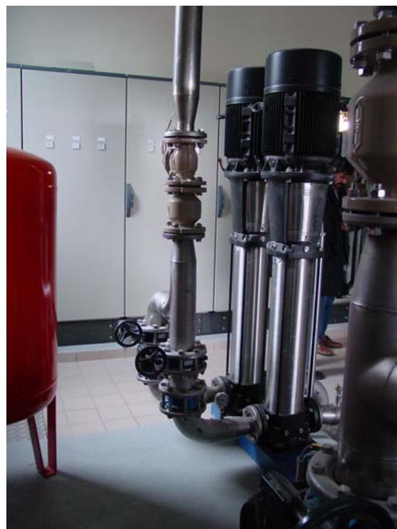
12 : Pompes de distribution vers Damblain
