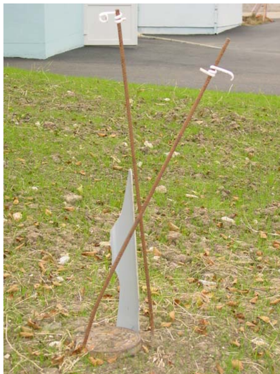
06 : Emplacement de la vanne de vidange
