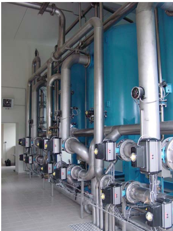
09 : Filtres de traitement
