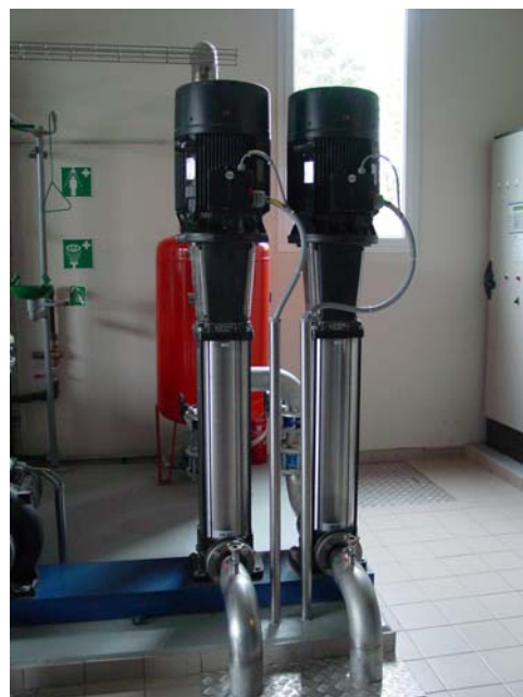
T02. Pompes de distribution de l'eau traitée de Damblain
