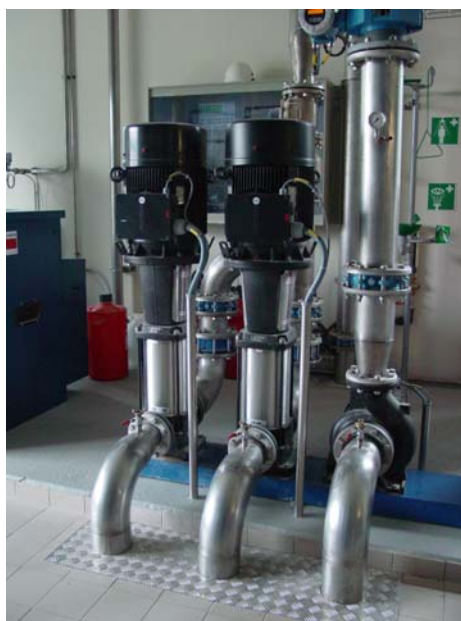
T03. Pompes de distribution de l'eau traitée de Crainvilliers (gauche) et conduite des eaux de lavage (droite)
