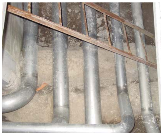
02 : Arrivée des conduites d'eau traitée et de l'eau de lavage du réservoir de la station vers les pompes de distribution et la désinfection
