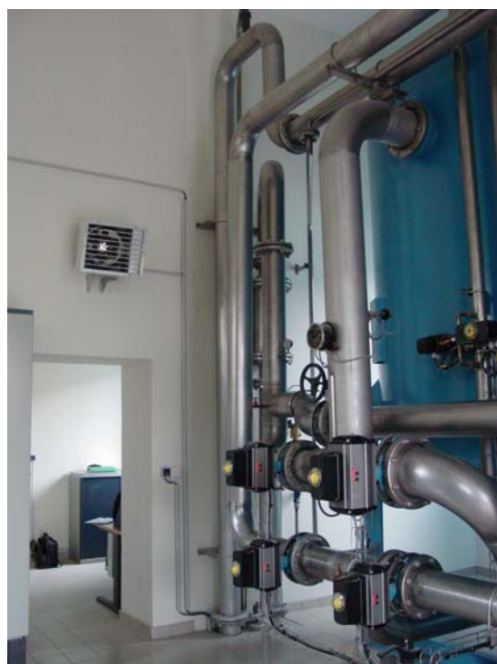
08 : Filtre de déferrisation avec vannes automatiques
