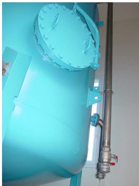
T12. Entrée et sortie pour le dépotage du filtre d'adsorption arsenic
