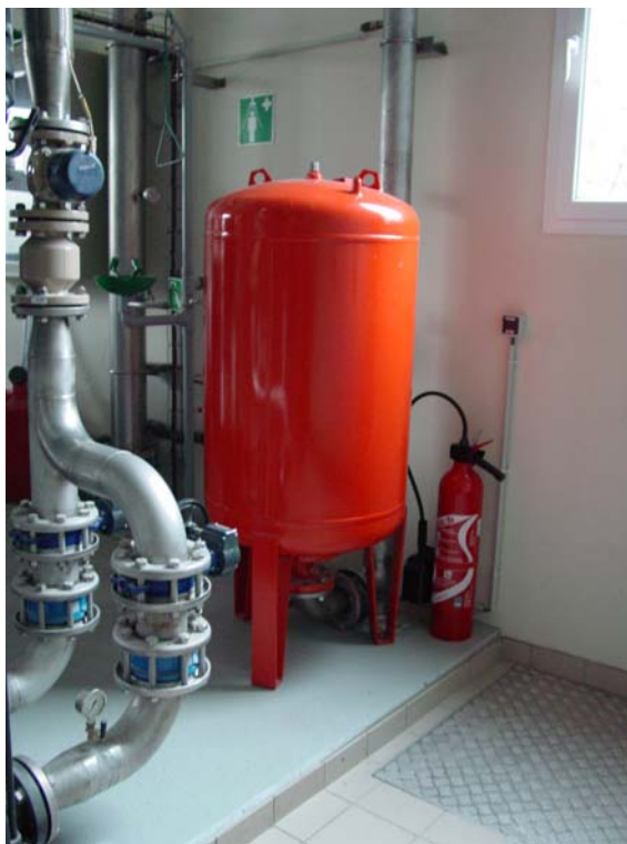
T05. Ballon anti-bélier pour la conduite de distribution vers Damblain
