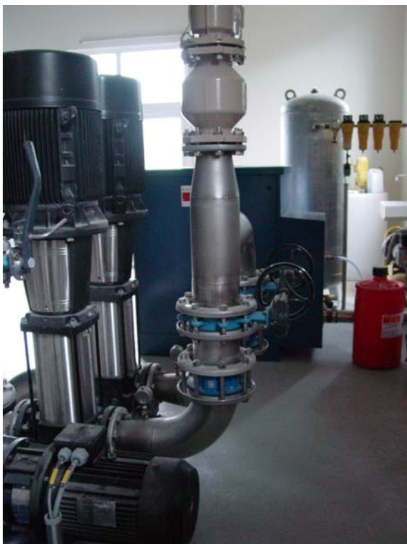
I3 : Pompes de distribution vers Crainvilliers
