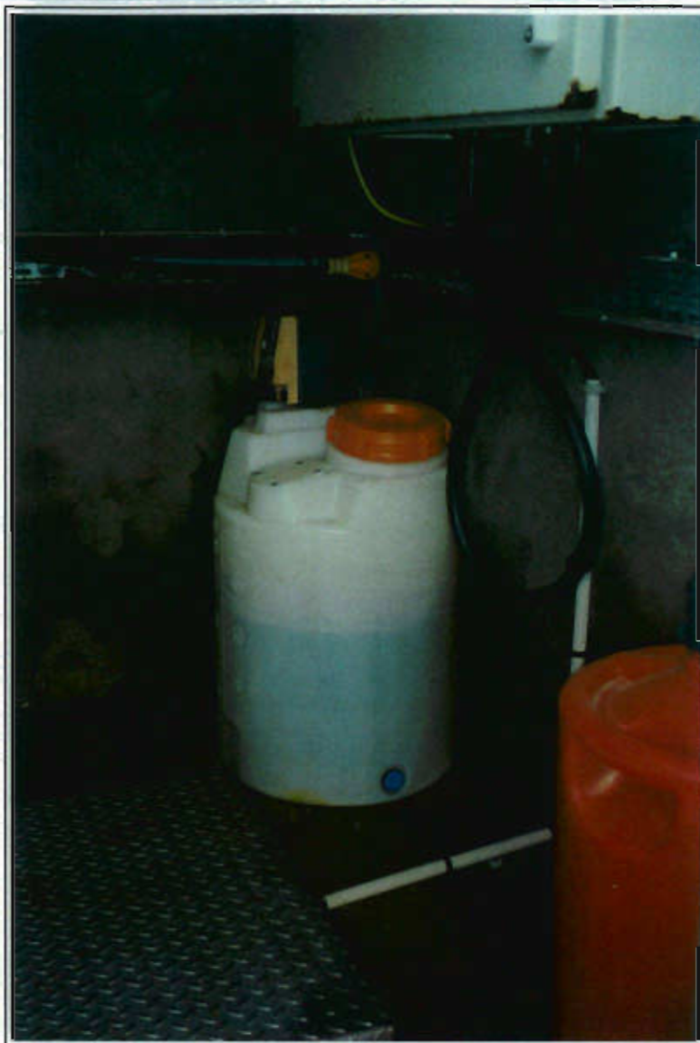
☞ Cliché n° 19 : Vue du dispositif de pré-chloration installé dans la station du Puits des Hailottes 1
