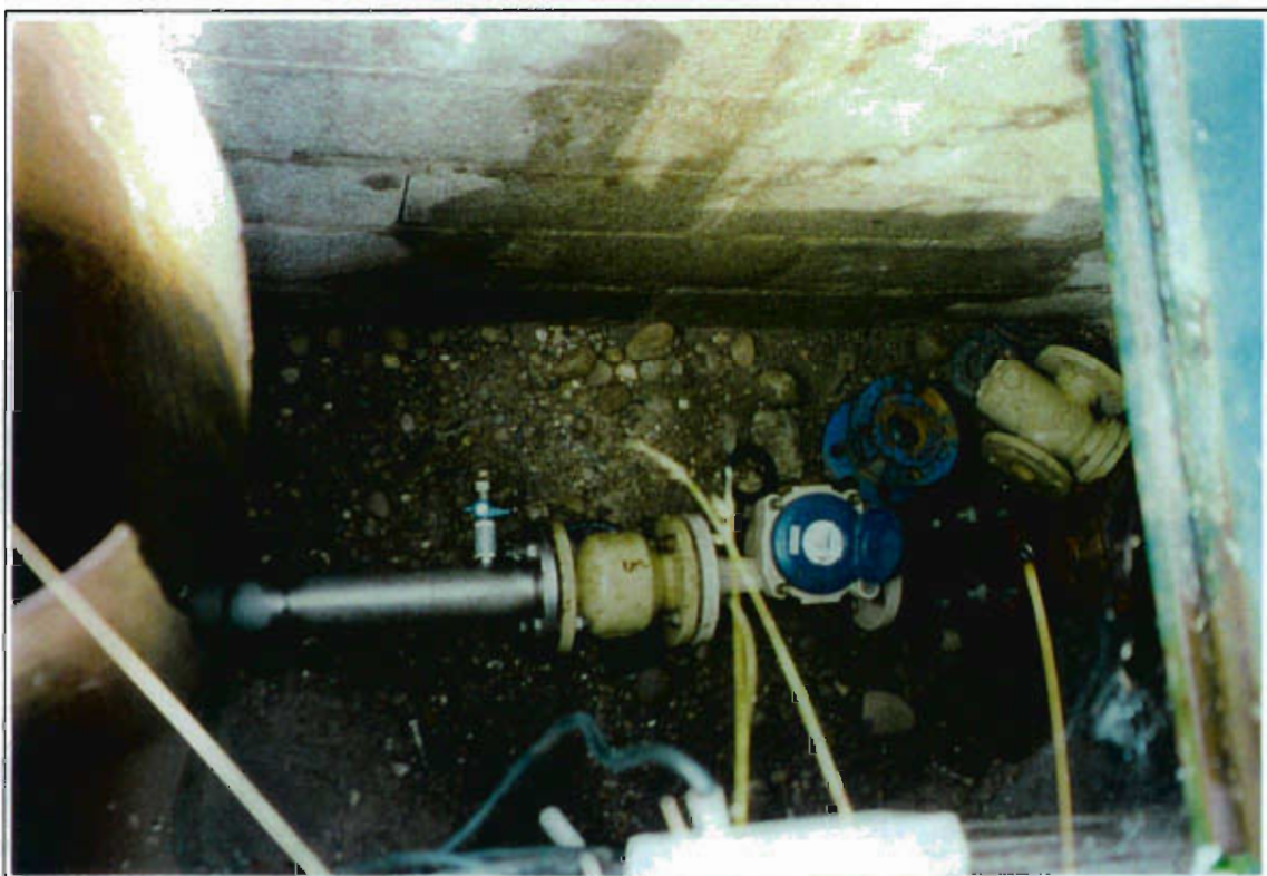
Cliché n° 26 : La ligne de refoulement et ses équipements dans le regard de tête
